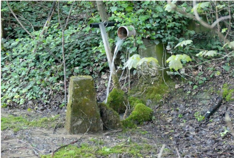
Abbildung 11: Zulaufrohr für den Teich der Kläranlage Eistal-West
