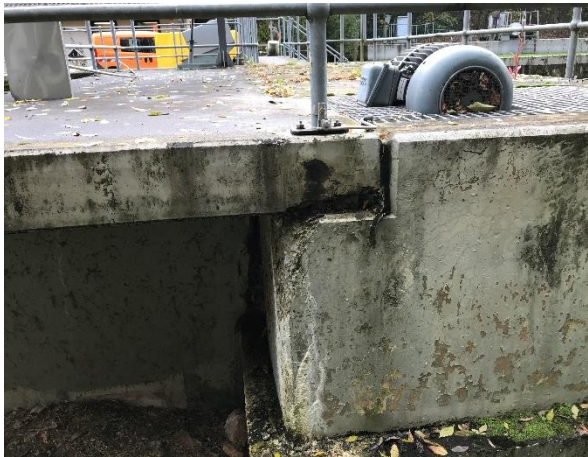
Abbildung 32: Schäden am Belebungsbecken
