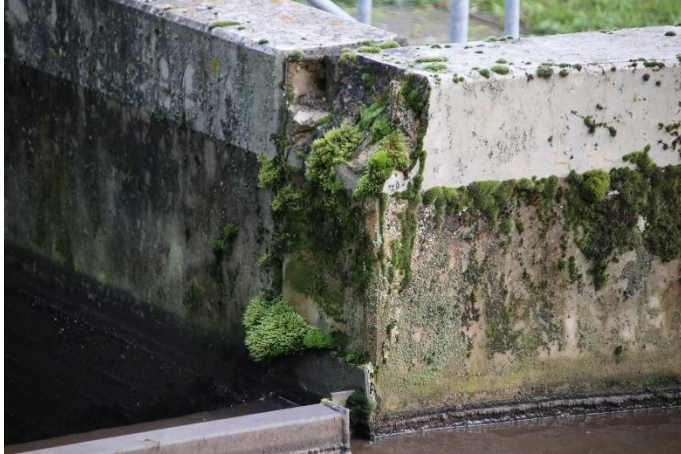
Abbildung 34: Schäden am Belebungsbecken
