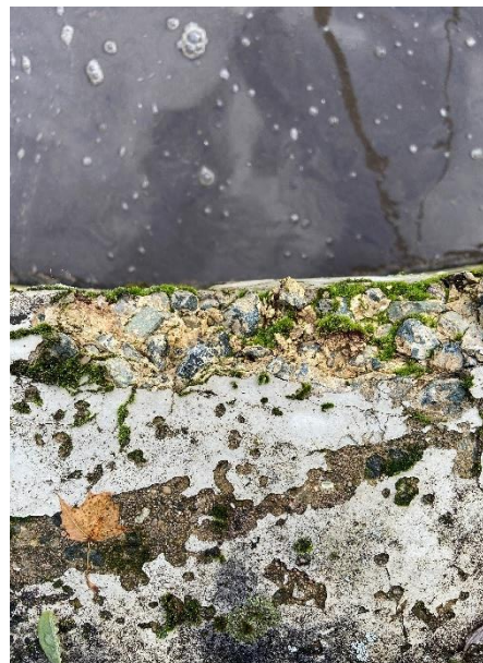
Abbildung 37: Schäden am Belebungsbecken
