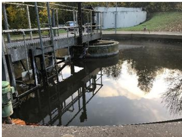
Abbildung 43: Nachklärbecken mit Schildräumer
