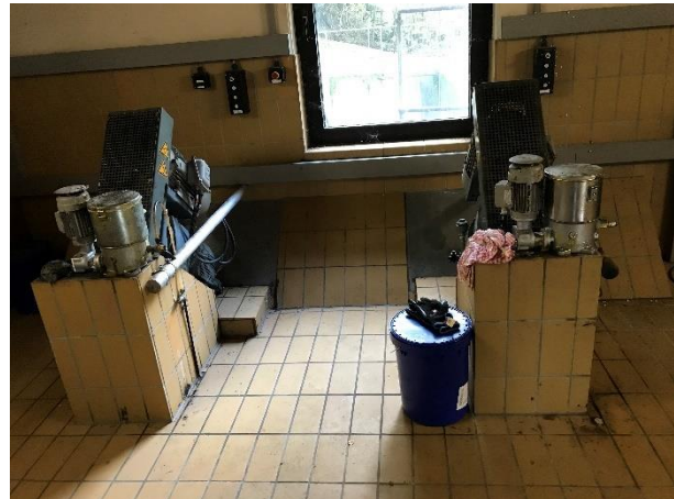
Abbildung 16: Schneckenantriebe im Rechengebäude
