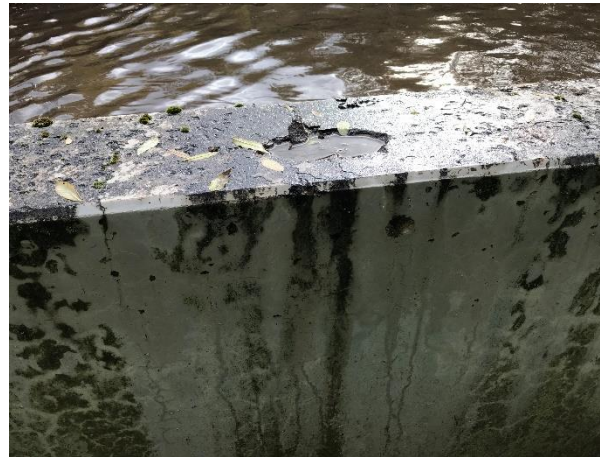
Abbildung 33: Schäden am Belebungsbecken
