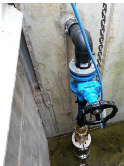
Abbildung 72: Brauchwasserpumpe Abflussschacht, beispielhaft
